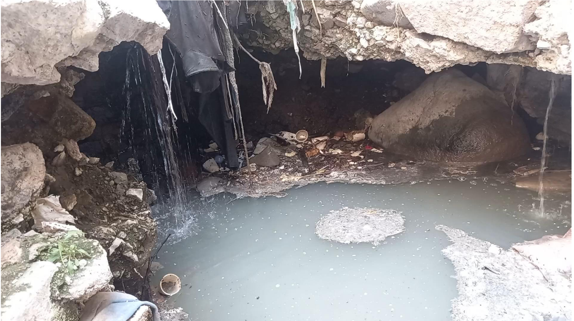
Socavón provocado por la corriente del agua del río y fugas en el drenaje, debajo de la vivienda ubicada en la Av. San Miguel y la Calle de Brisas en la colonia Ampliación Malacates.
